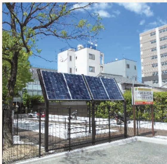
梅小路公園駐車場設置の太陽光パネル
