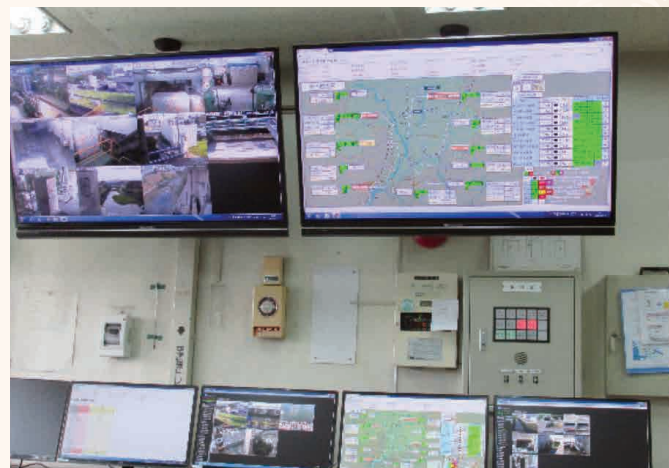
洲崎排水機場内 排水機場集中管理センター
