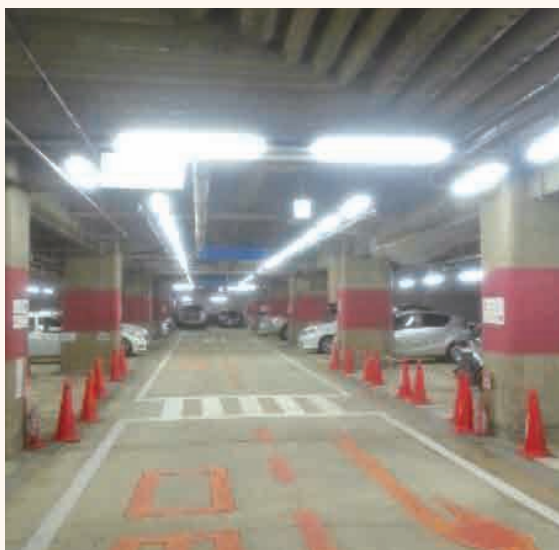
京都駅八条口駐車場 LED 照明灯
